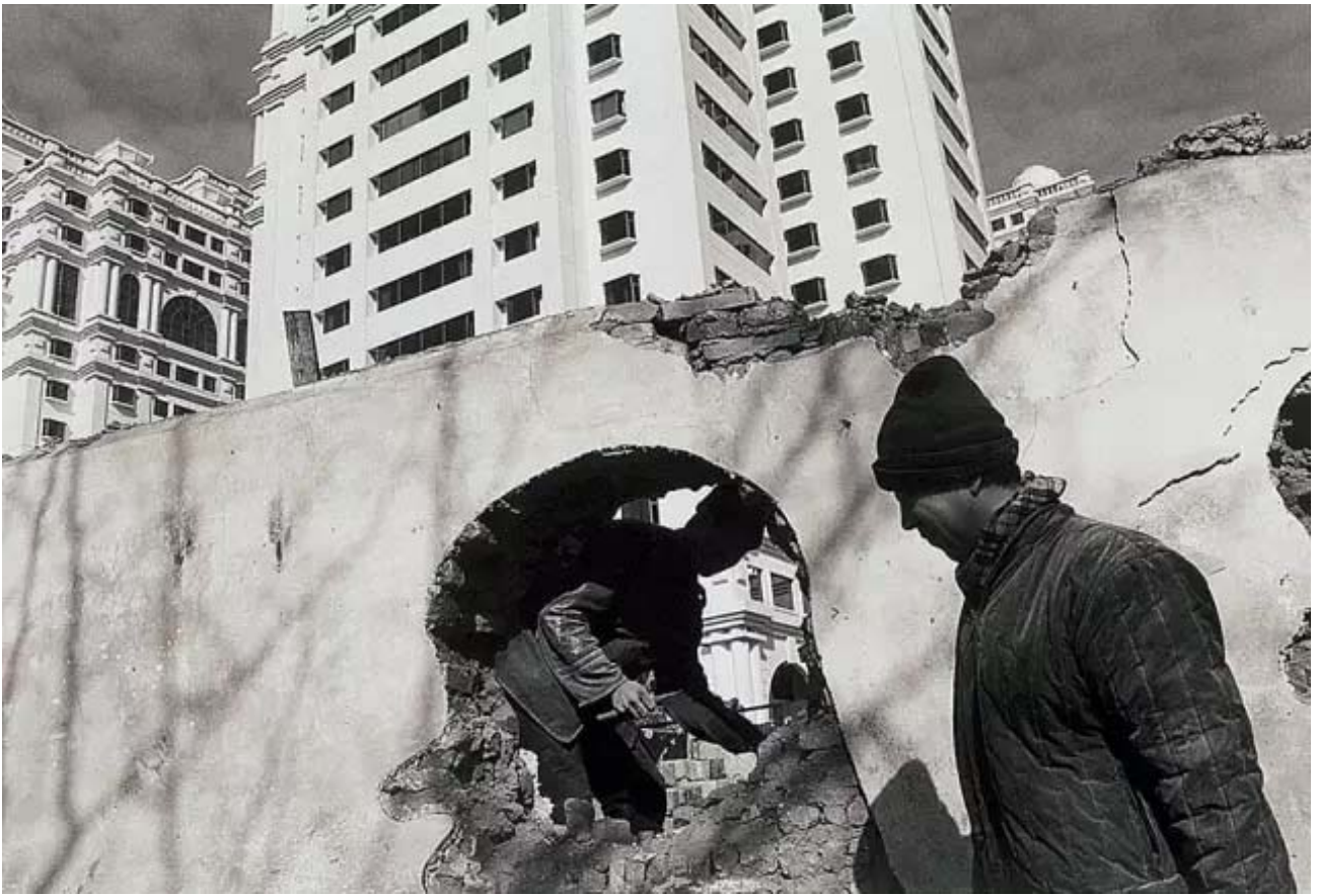
拆一 东二环富华大厦 北京 1998
